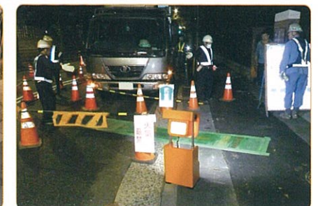
安全対策、歩行者用足元照明
